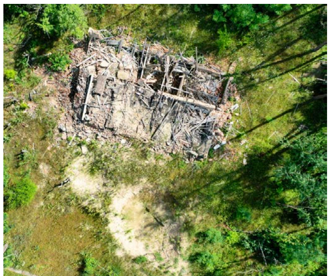
Luftaufnahme einer Drohne während einer nicht-technischen Untersuchung, die ein beschädigtes Gebäude zeigt (Juli 2023).
