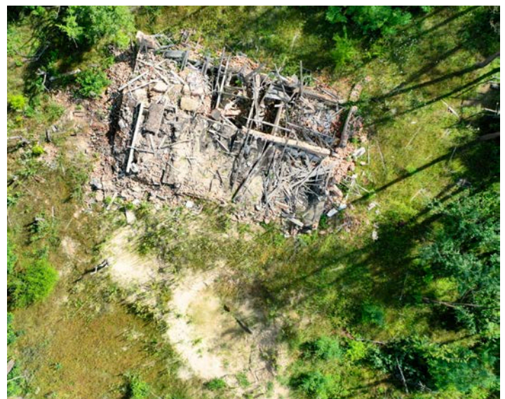
Luftaufnahme einer Drohne während einer nicht-technischen Untersuchung, die ein beschädigtes Gebäude zeigt (Juli 2023).
